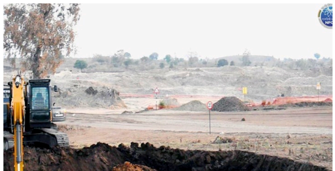
Zahájení výkopových prací pro jaderný projekt Mahi Banswara (stát Rádžasthán, severozápadní Indie) [4]
